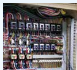
控制盤內機器異常發熱
